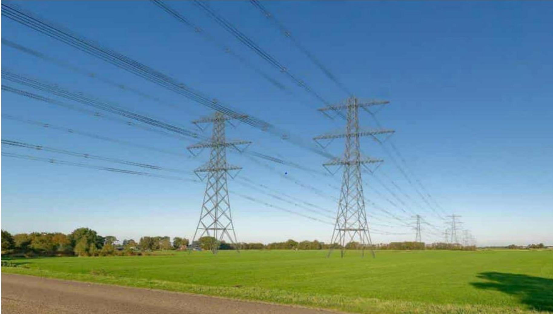
Dubbele rij Moldau masten
